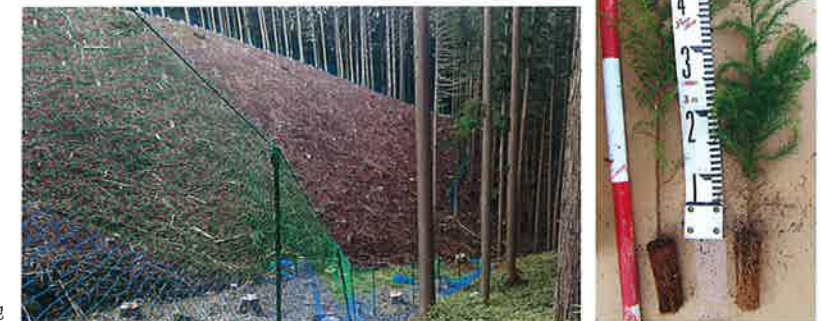
獣害防止柵(外周を囲むステンレス入りネット)を設置中の皆伐地
